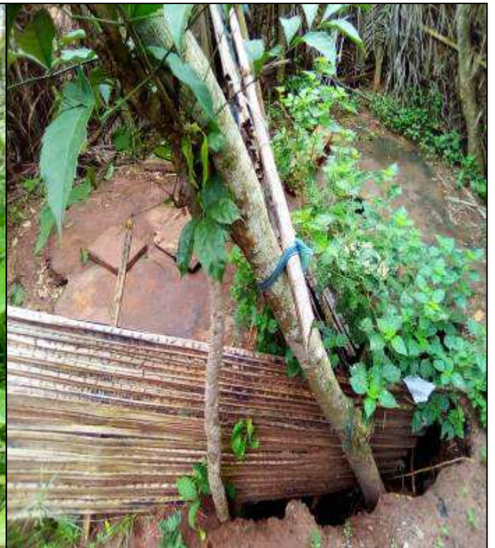
Latrine effondrée recensée dans Sogbé Aligo- centre
