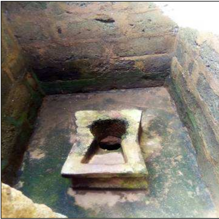
Latrine mal entretenue recensée dans Késsouléhoué à Sogbé-Alogo
